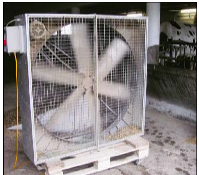
Avec le ventilateur, on peut atteindre un renouvellement d'air suffisant en stabulation entravée
